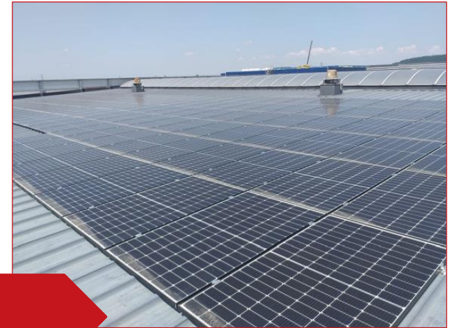
własna instalacja PV w Skawinie
